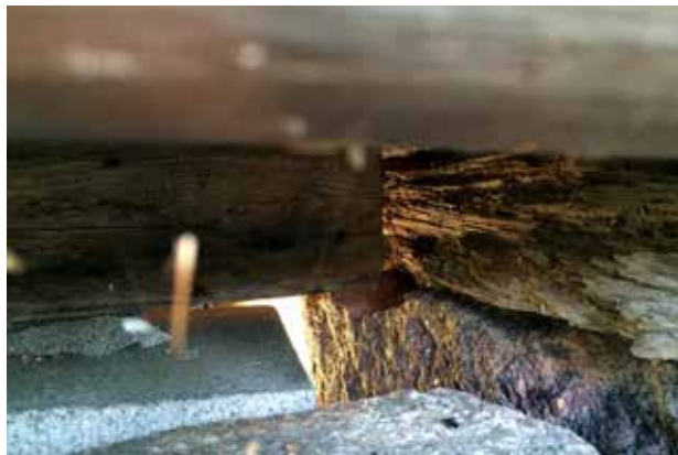
Tuulettuva rossialapohja. Rakennuksen lattia on irrallaan rungosta. Alin hirsikerta edellyttää tarkistamisen ulkovuoren korjauksen yhteydessä.
