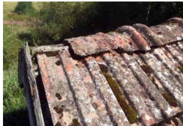
Vesikaton betonitiilet ovat hyvässä kunnossa. Rästäs ja tuulilaudat edellyttävät korjaamista.
