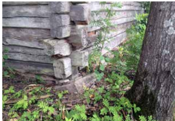
Luoteiskulman liikkunut nurkkakivi.
