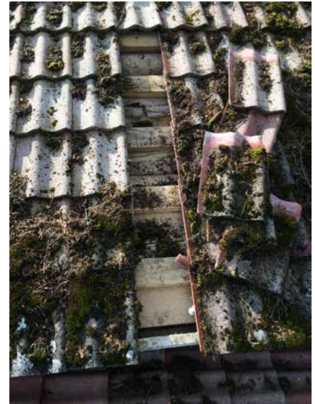
Ulkoseinän ulkopinnan sisäpuolelle päättyvä aluskate aiheuttaa riskin kosteusvauriolle.
