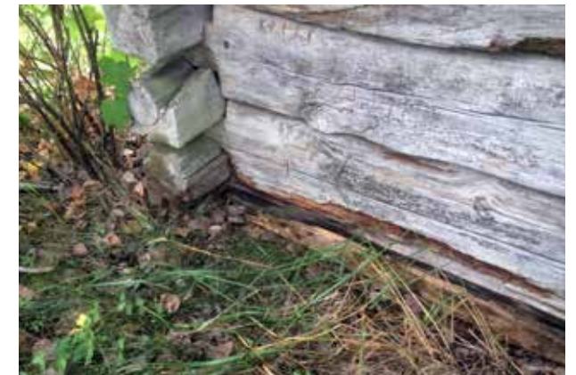
Maanpinnan nouseminen ja perustuksen painuminen on saattanut alimman hirsikerran jatkuvaan kosteusrasitukseen.
