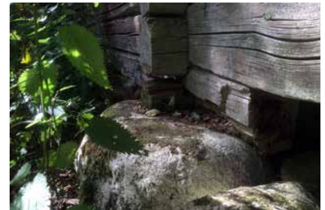
Riihen nurkkakivi on siirtynyt paikoiltaan ja hirsikehä on osittain ilman tukea.
