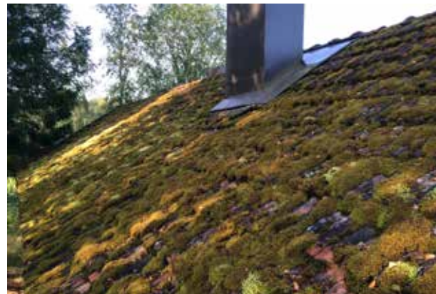
Katon itä-lape on sammaloitunut ja edellyttää puhdistamisen sekä vuotokohtien korjaamisen.
