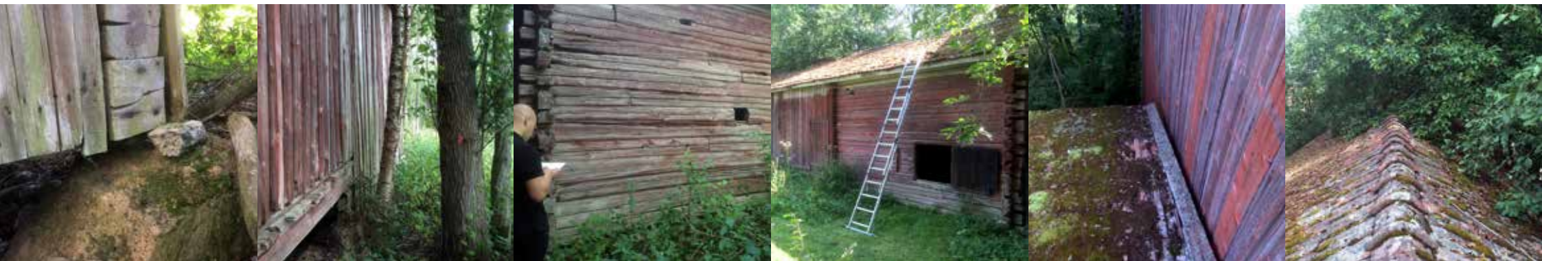
Kuvat vasemmalta oikealle: 1. Rakennuksen lounaiskulman liikkunut nurkkakivi on jättänyt rakennuksen tyhjän päälle. 2. Rakennuksen takana oleva puusto vaatii harvennusta. 3. Itäseinän hirsien suojaksi suositellaan pystylaudoitusta. 4. Maanpinta tulee muotoilla rakennuksesta pois päin kaatavaksi. 5. Riihi on lähes kiinni liiterirakennuksessa. 6. Puuston harvennus vähentää katolle tulevaa roskaa ja rasitusta.
