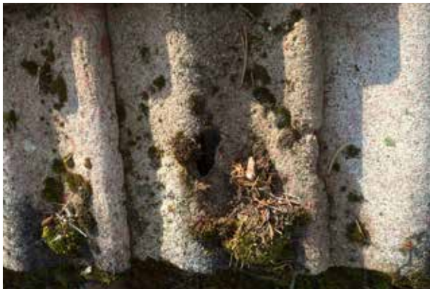
Hauraat aalto-malliset kattotiilet ovat käyttöikänsä lopussa.
