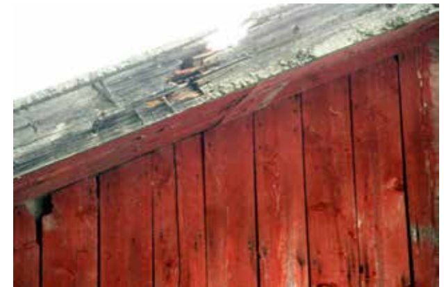
Lahovaurio rakennuksen eteläpäädyn räystässä.
