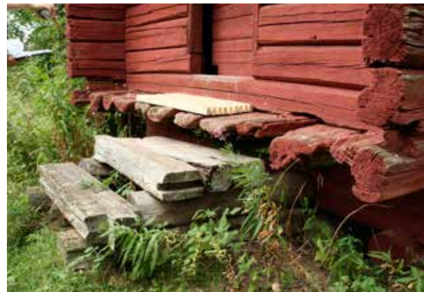
Käyttöturvallisuuden takaamiseksi aitan sisäänkäyntiporras täytyy uusua.
