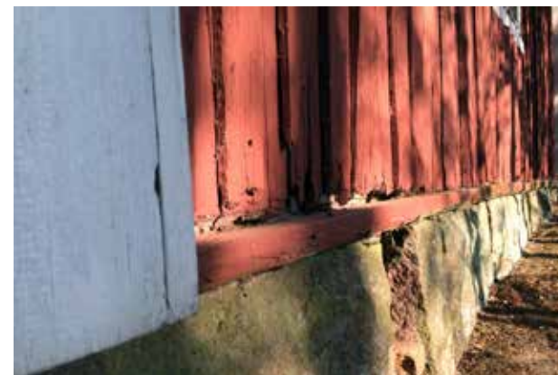
Torpan ulkovuorauksen alareuna ja tippalista täytyy korjata.
