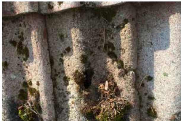
Päärakennuksen kattotiilet ovat hauraat ja paikoin pahasti rapautuneet.
