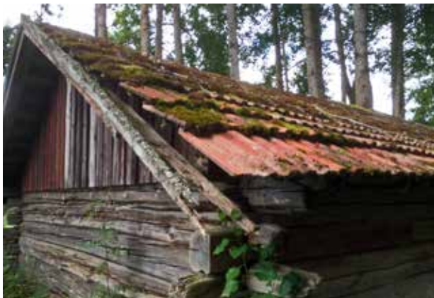
Rakennuksen koilliskulman lahovaurioitunut räystääs.
