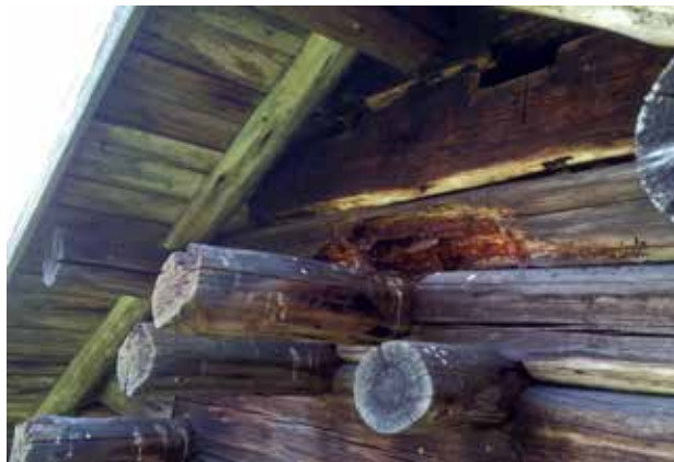
Etuseinän yläosan lahovaurio ei laajene ja siten ei edellytä välittömiä toimenpiteitä.
