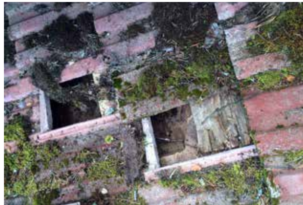
Kuistin lahovaurioituneet kattorakenteet edellyttävät korjaamista.
