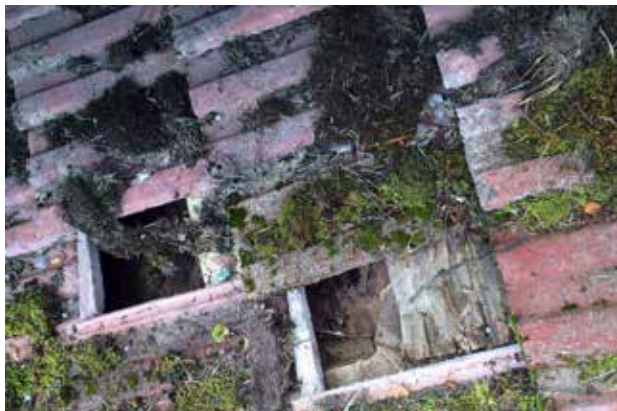
Päärakennuksen kuistin katon rakenteet ovat paikon lahoneet lehtien, roskien, huonon tuuletavuuden ja vaurioituneiden tiilien vuoksi.
