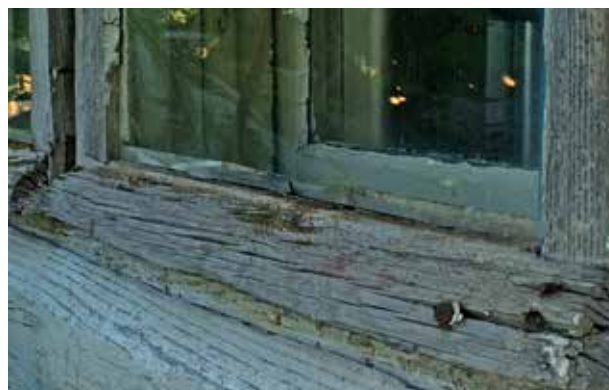
Korjausmaalauksen tarpeessa oleva ikkunapuite. Nukkaantunut puuainehotaan kovalle puulle, suoritetaan pohjamaalaus, halkeamat kitataan ja lopuksi puite pintamaalataan.
