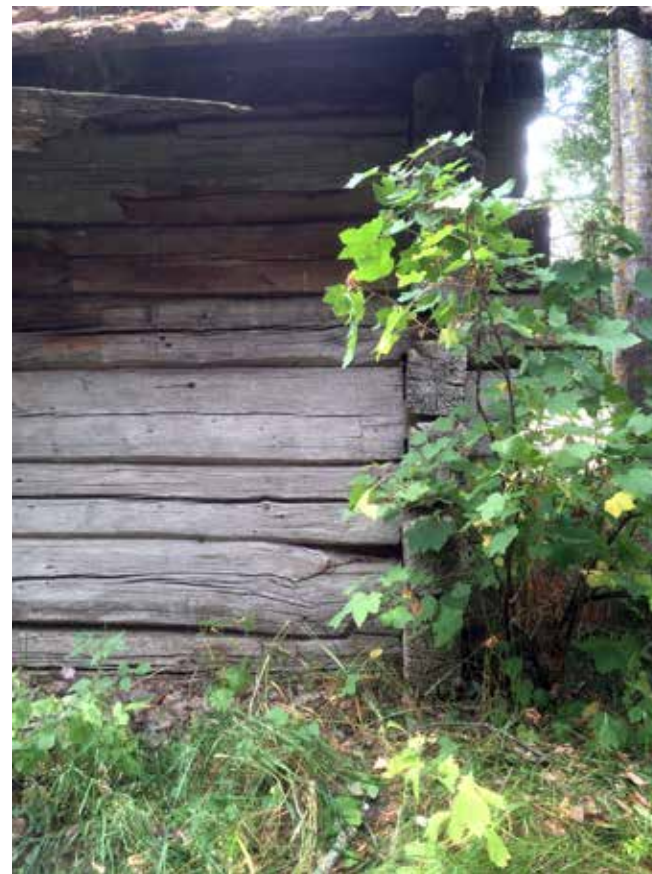
Alahirressä kiinni oleva maa aiheuttaa jatkuvan kosteusrasituksen rakennuksen runkoon.
